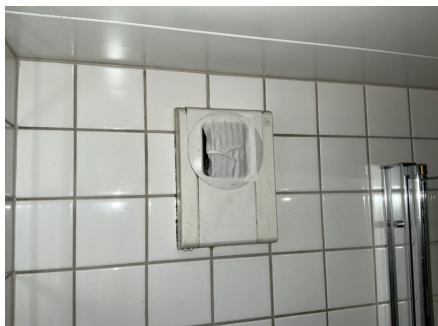
Kontroll av avtrekk.
