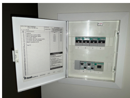
Automatsikringer i sikringsskap plassert i entré
