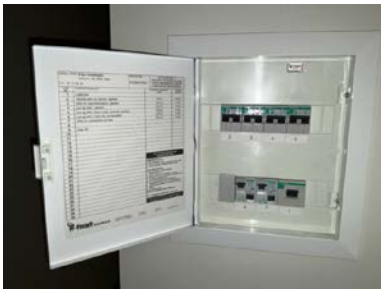
Automatsikringer i sikringsskap plassert i entré
