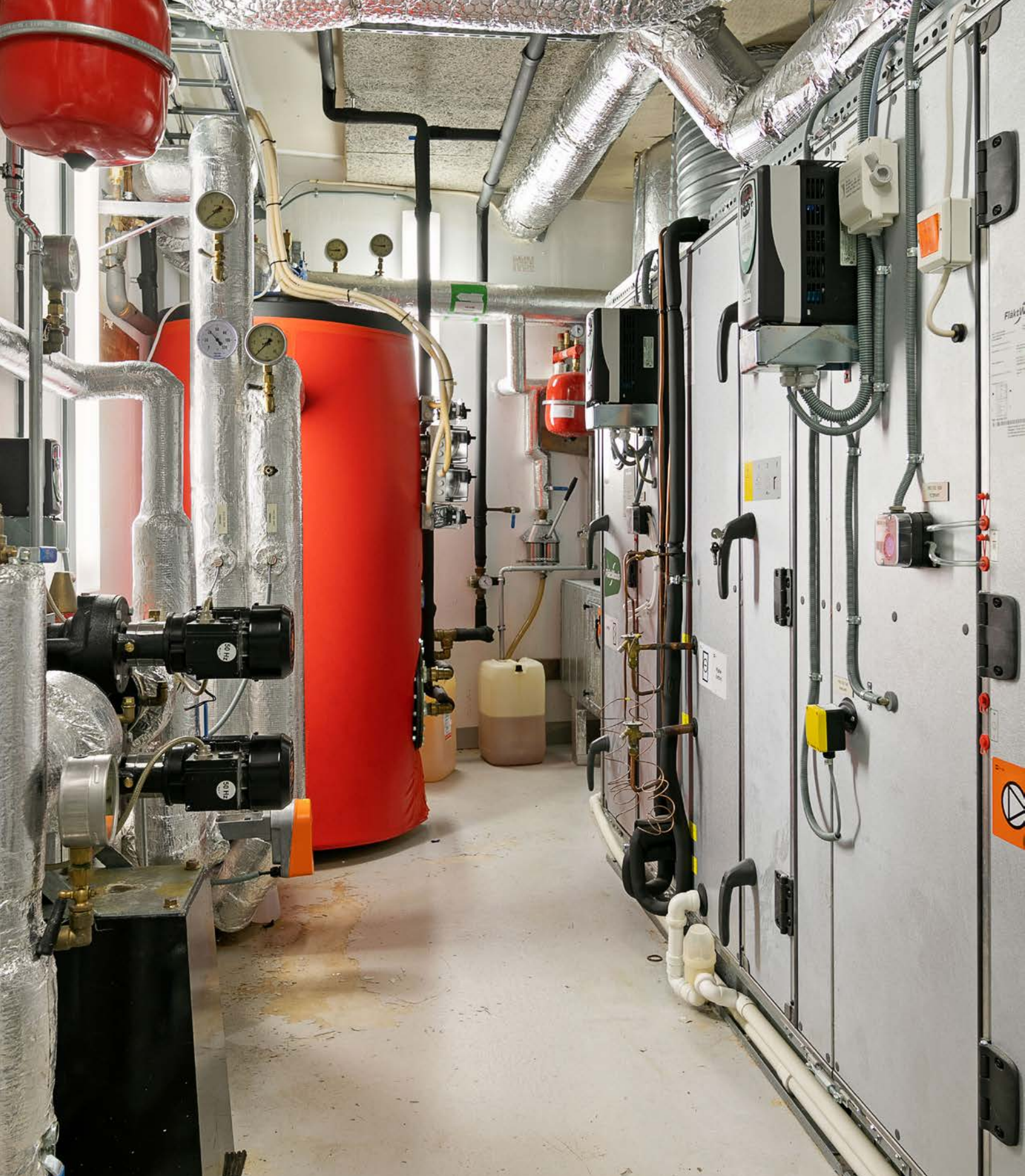
Teknisk rom med 300 L varmtvannsbereder, luft til vann - 2 varmepumper, balansert ventilasjon med varmegjenvinning.
