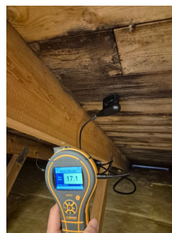
Målt noe høye fuktverdier i rupanel.
