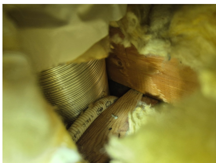
Brudd på dampsperre rundt rørgjennomføring.
