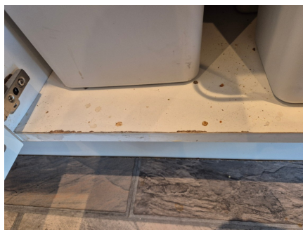
Fuktsveller i bunnskap.
