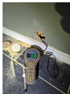
Ikke målt noe unormale fuktverdier bunnsvill.
