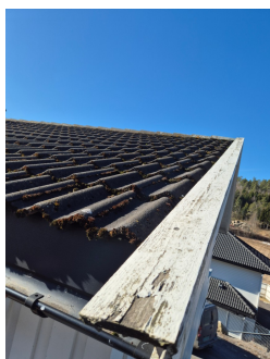
Værslitte israftbord og noe mosebelagt takstein.
