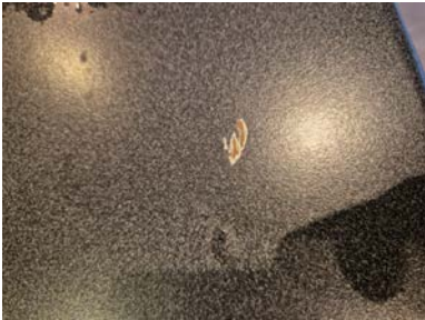
Skade på benkeplate.
