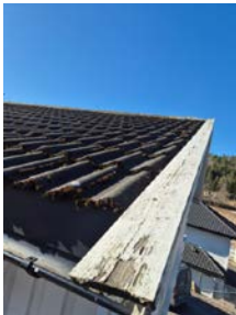
Værslitte israftbord og noe mosebelagt takstein.
