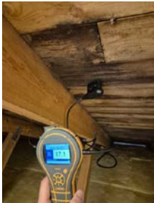
Målt noe høye fuktverdier i rupanel.
