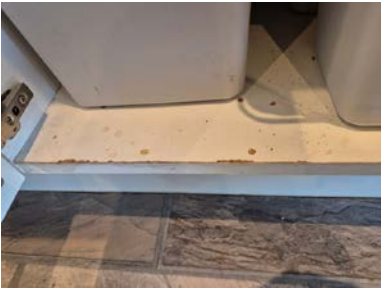
Fuktsveller i bunnskap.
