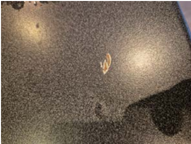
Skade på benkeplate.
