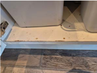
Fuktsveller i bunnskap.
