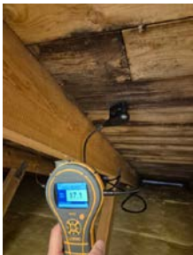
Målt noe høye fuktverdier i rupanel.
