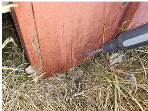
Bilde viser råteskadet kledning.
