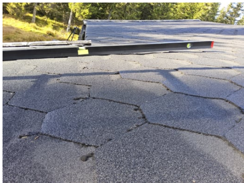
Bildet viser skjevheter i takkonstruksjonen.
