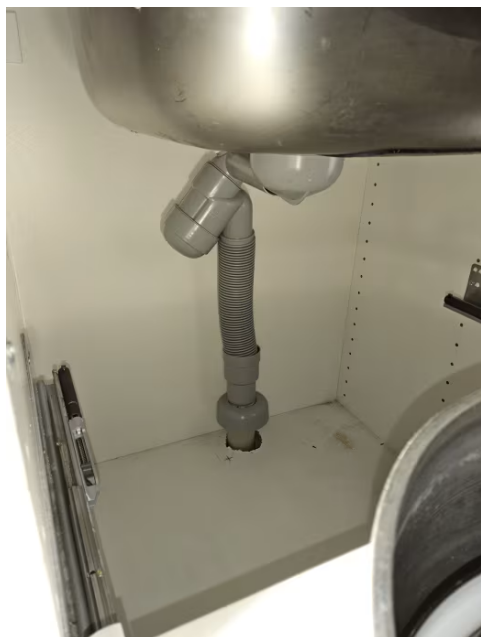
Avløpsrør av plast under kjøkkenkum.
