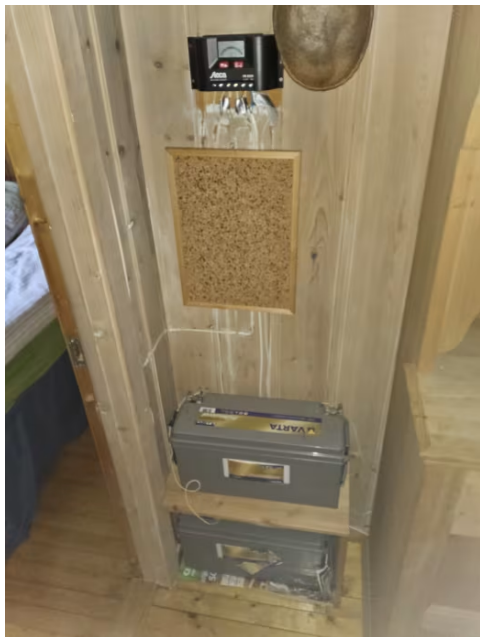
Batterier tilknyttet solcelleanlegg er plassert i stue/kjøkken.
