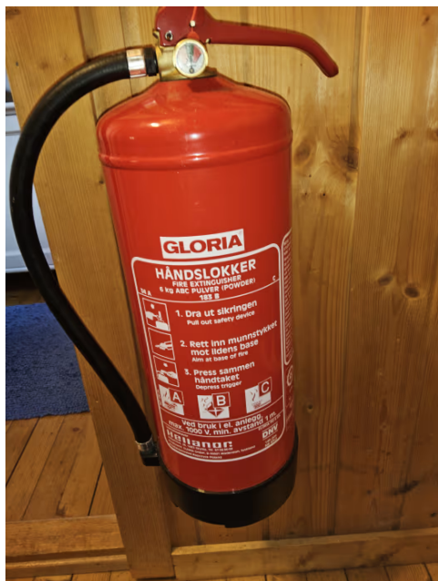
Brannslukningsapparat ble sist kontrollert i 2010.
