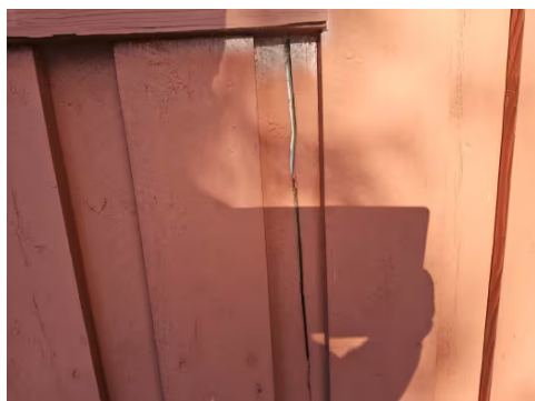
Bilde viser sprekt kledningsbord.
