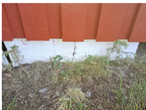
Bilde viser fundament med gjennomgående sprekk.
