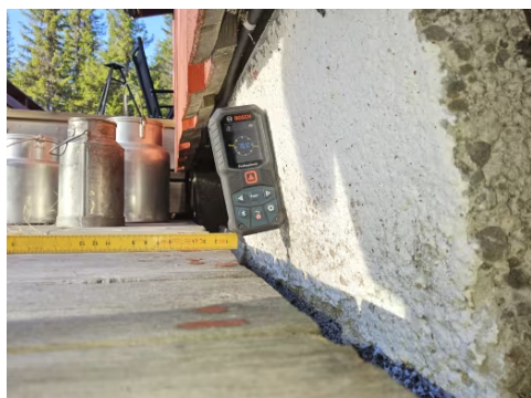
Bilde viser fundament som står skjevt.
