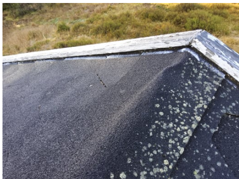
Bildet viser buler i takpapp på mønet.
