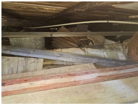
Innbo/løsøre under bjelkelaget anbefales fjernet.
