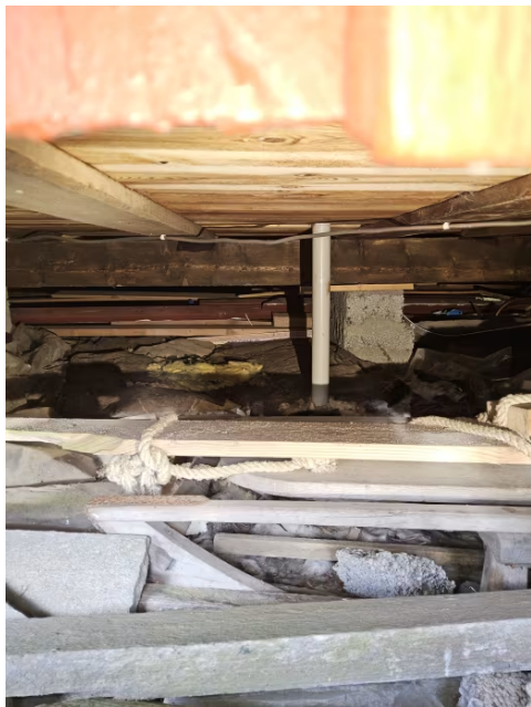
Avløpsrør er ført direkte ned i grunnen.
