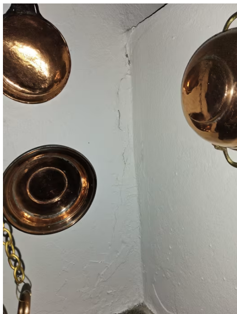
Bildet viser riss/sprekker i hjørnet mellom brannmur og pipe.
