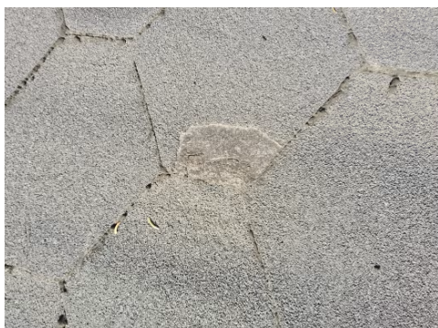
Det registreres enkelte skader på pappshingel.
