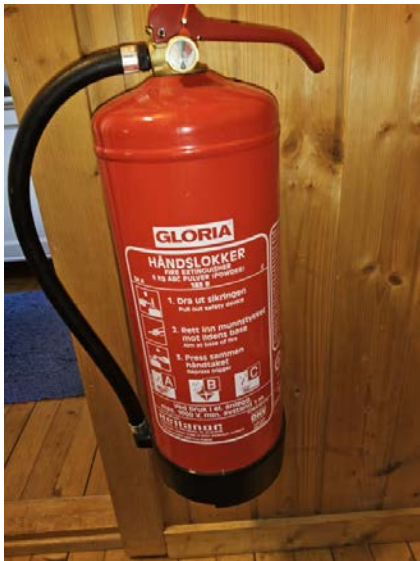
Brannslukningsapparat ble sist kontrollert i 2010.
