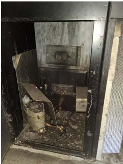
Bilde viser oljekamin.
