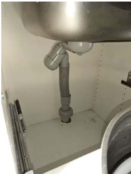
Avløpsrør av plast under kjøkkenkum.
