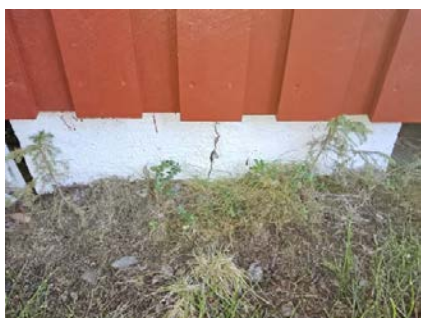
Bilde viser fundament med gjennomgående sprekke.
