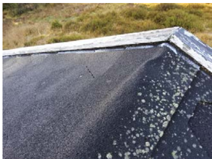
Bildet viser buler i takpapp på mønet.
