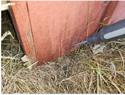
Bilde viser råteskadet kledning.
