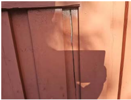
Bilde viser sprekt kledningsbord.
