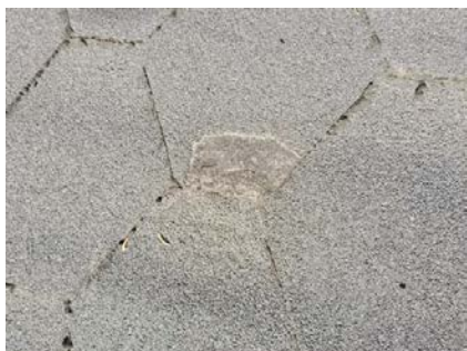
Det registreres enkelte skader på pappshingel.
