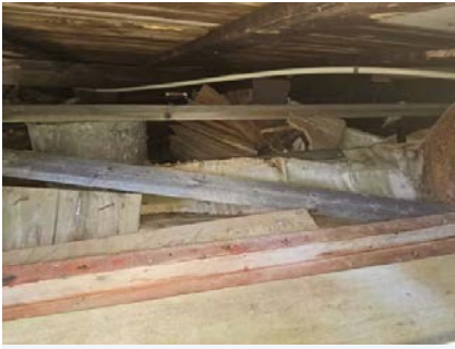
Innbo/løsøre under bjelkelaget anbefales fjernet.
