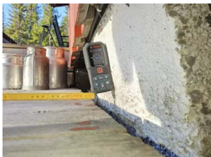
Bilde viser fundament som står skjevt.
