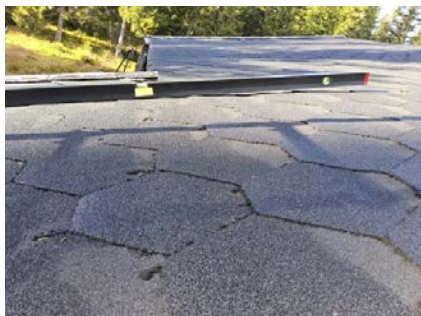
Bildet viser skjevheter i takkonstruksjonen.
