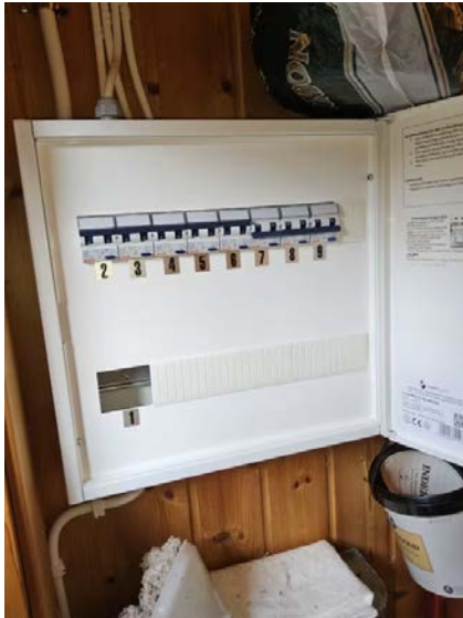
Sikringskap plassert i utebod.
