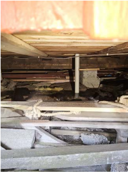
Avløpsrør er ført direkte ned i grunnen.
