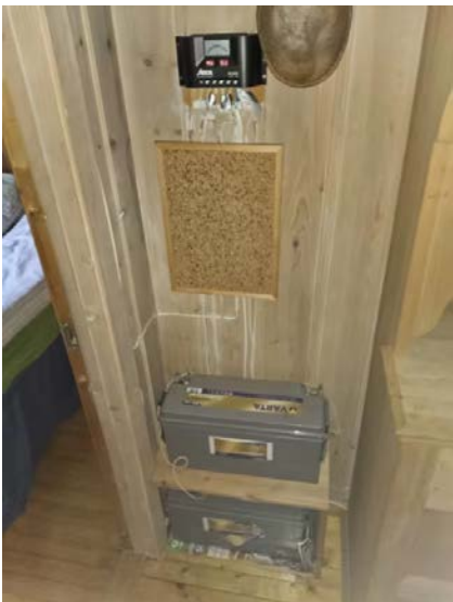
Batterier tilknyttet solcelleanlegg er plassert i stue/kjøkken.
