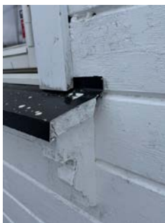
Utvendige beslagsløsninger er ikke fagmessig utført.
