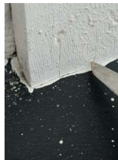
Belistning som er montert helt ned på vannbrettet
