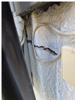
Sprekk i overgang mot tilbygget stue.
