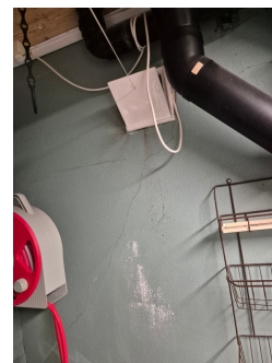
Sprekker i pusslag mot gårdsplass i vaskerom.
