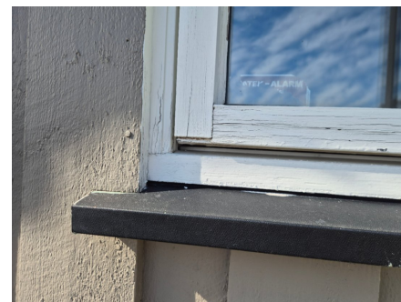
Kledningsbord ført helt ned til beslag.
