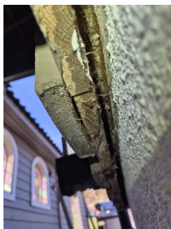
Kledning kappet rett og ingen lufting i nedre del.
