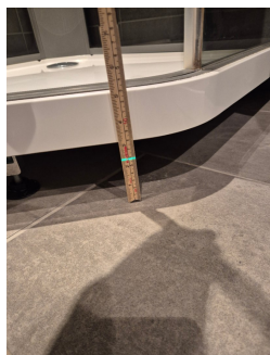
Målt fra 5,7 cm ved dusjkabinett (målt samme ved sluk)...
