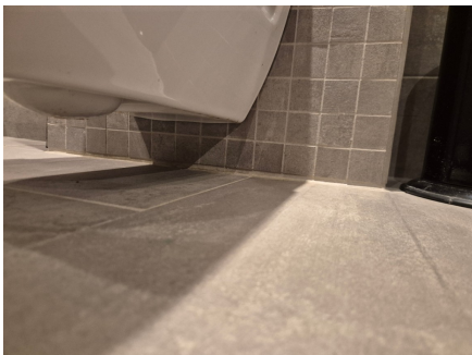
Ingen drensspalte under toalett.
