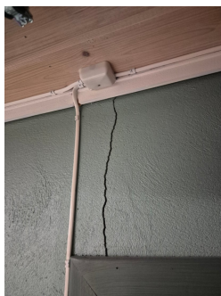
Sprekk i mur mot bod fra vaskerom.
