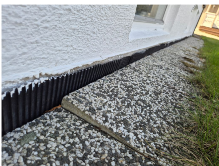
Grunnmursplast glidd ned fra pusslag.
