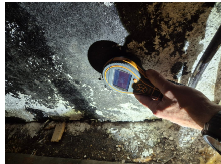
Synlig saltutslag og indikert høye fuktverdier.
