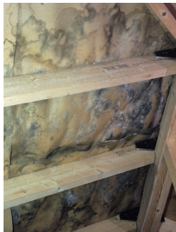
Skjolder og soppdannelser på undertak.
