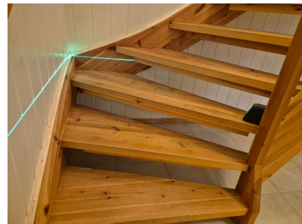
Målt 4 cm skjevheter i trinn.
