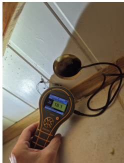
Målt noe høye fuktverdier ved hulltaking.
