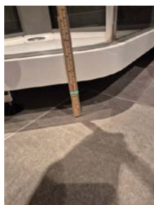
Målt fra 5,7 cm ved dusjkabinett (målt samme ved sluk)...
