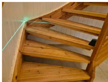
Målt 4 cm skjevheter i trinn.
