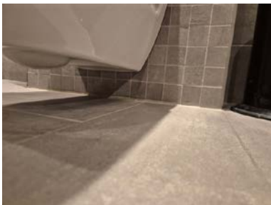
Ingen dreusspalte under toalett.
