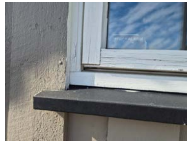
Kledningsbord ført helt ned til beslag.
