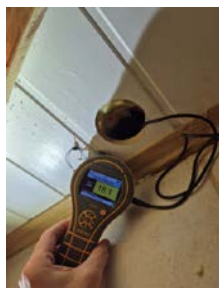
Målt noe høye fuktverdier ved hulltaking.
