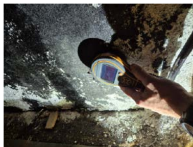
Synlig saltutslag og indikert høye fuktverdier.
