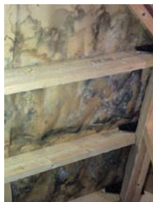
Skjolder og soppdannelser på undertak.
