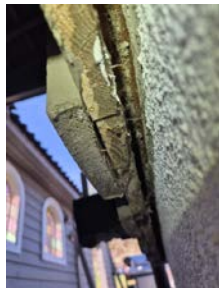
Kledning kappet rett og ingen lufting i nedre del.
