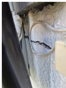
Sprekk i overgang mot tilbygget stue.
