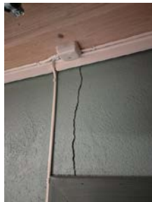
Sprekk i mur mot bod fra vaskerom.
