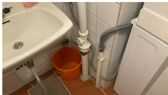
Avløpsrør i plast og støpejern
