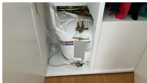
Varmtvannsbereder i skap på soverom 1.et.
