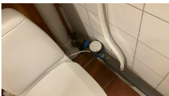
Vanninntak, stoppekran og vannmåler.
