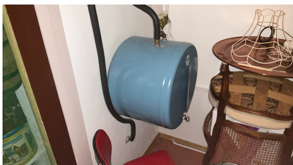
Varmtvannsbereder i kjeller.
