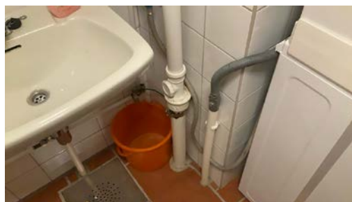
Avløpsrør i plast og støpejern
