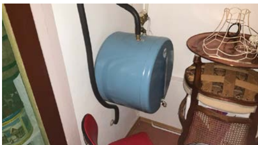
Varmtvannsbereder i kjeller.
