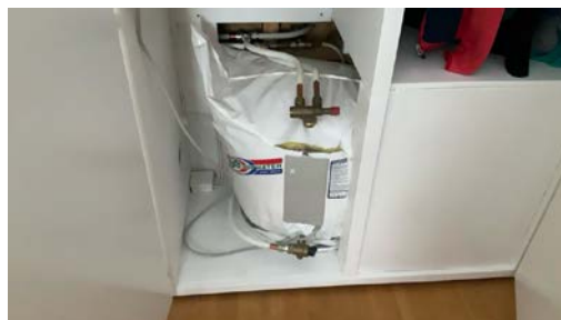
Varmtvannsbereder i skap på soverom 1.et.
