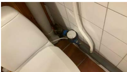
Vanninntak, stoppekran og vannmåler.
