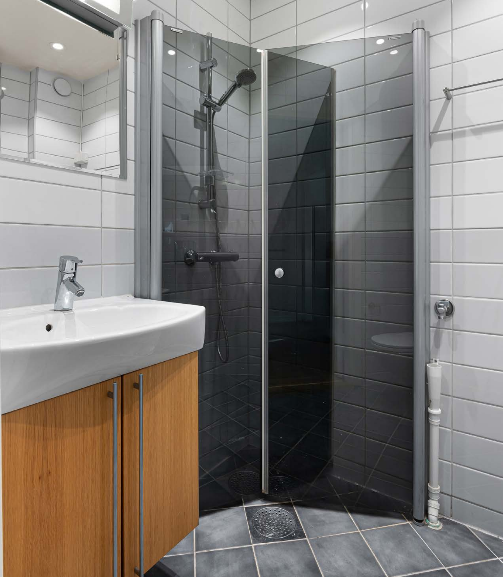
Pent flislagt bad/wc rehabilitert i 2004 med bl.a. fliser, nytt plast gulvsluk med klemring for foliemembran og varmekabler gulv.
