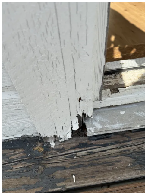
TG3: Råteskadet belisting.
