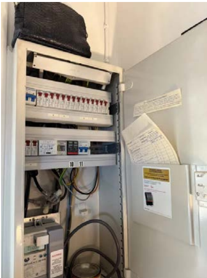
Sikringsskap er plassert i entre. Kursoversikt på innside skapdør.
