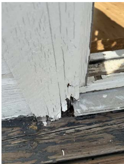
TG3: Råteskadet belisting.
