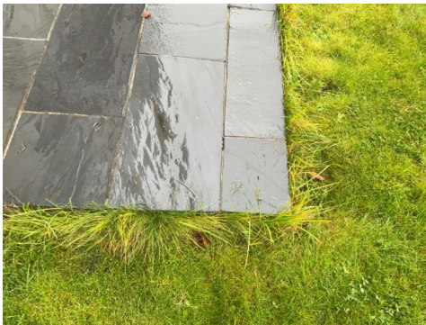
Løse fliser på platting.
