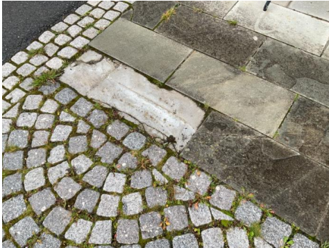
Manglende skifer i forbindelse med inngangsparti.
