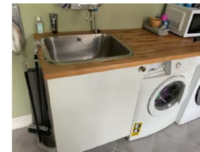
Innredning og opplegg til vaskemaskin.
