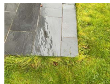
Løse fliser på plattning.
