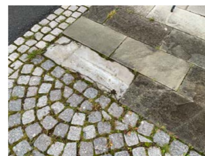
Manglende skifer i forbindelse med inngangsparti.
