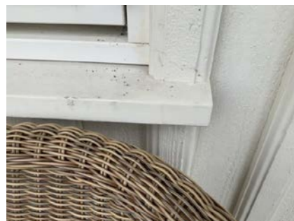
Liten avstand mellom vindusbelistning og beslag.
