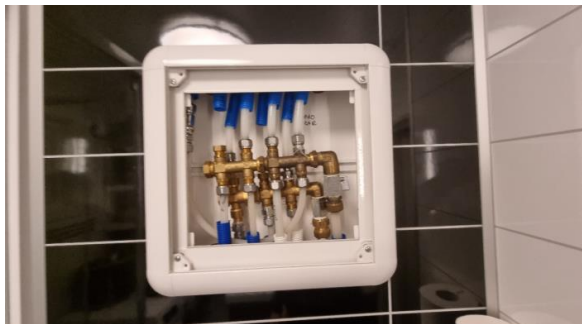
Kontroll av rørfordelerskap.
