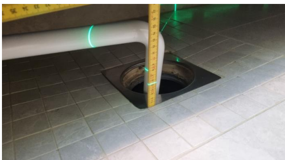
Det er lokalt fall rundt sluk.
