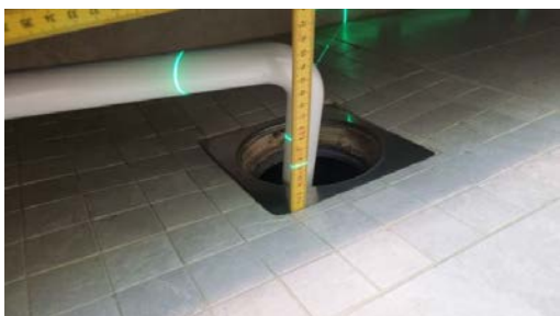
Det er lokalt fall rundt sluk.
