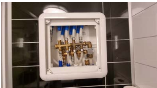
Kontroll av rørfordelerskap.
