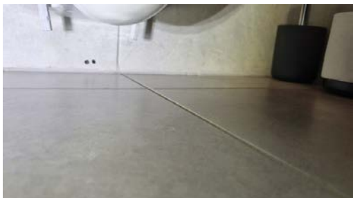
Drensåpning for synliggjøring av eventuelt lekkasjevann fra sistene.
