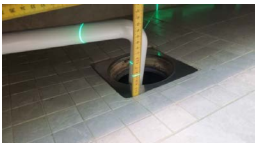
Det er lokalt fall rundt sluk.
