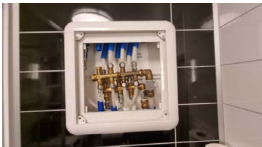
Kontroll av rørfordelerskap.
