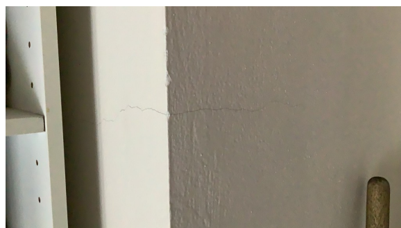
Riss i pipe.
