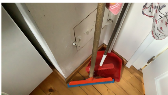
Det er ikke ildfast plate under sotluke.
