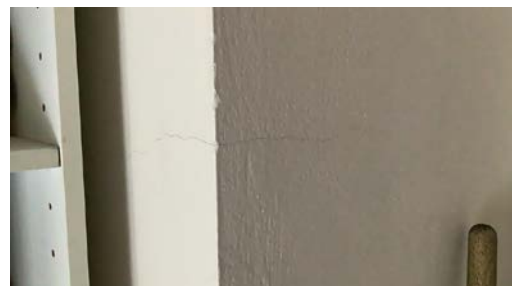
Riss i pipe.
