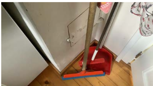
Det er ikke ildfast plate under sotluke.
