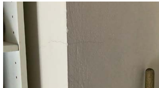
Riss i pipe.
