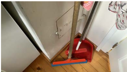
Det er ikke ildfast plate under sotluke.
