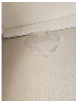
Reparasjon av vegg er ikke ferdigstilt.
