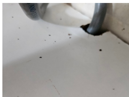
Fuktskadet bunnplate i benkeskap under vask.
