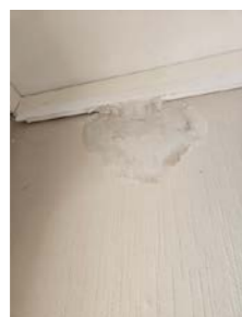
Reparasjon av vegg er ikke ferdigstilt.
