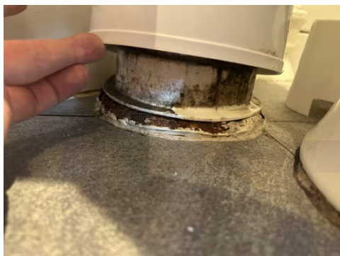
Manglende tettesjikt på rørgjennomføring.
