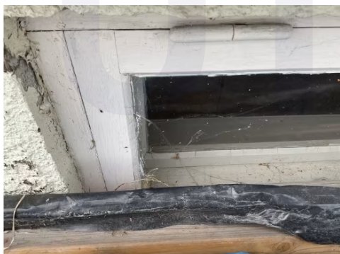
Sprekk i vindu.
