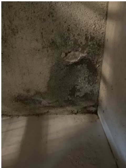
Salt/kalkutslag på pipe i kjeller.
