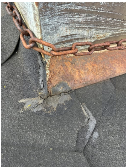
Skade på beslag og shingel rundt pipe.
