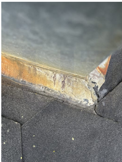
Skade på beslag og shingel rundt pipe.
