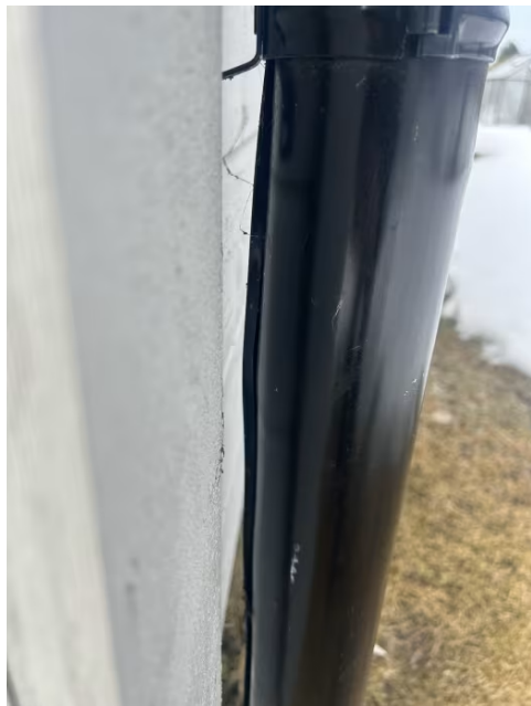
Frostspreng i nedløp.
