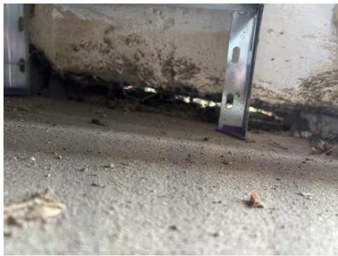
Manglende grunnmur på garasje.
