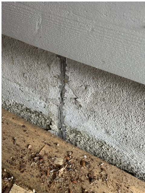
Sprekker i grunnmur på garasjen.
