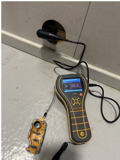
Fuktmåling i påforet vegg.
