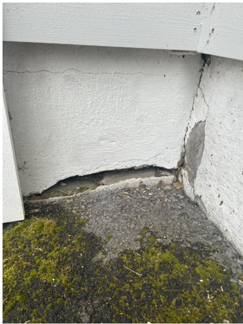
Manglende grunnmur på garasje.
