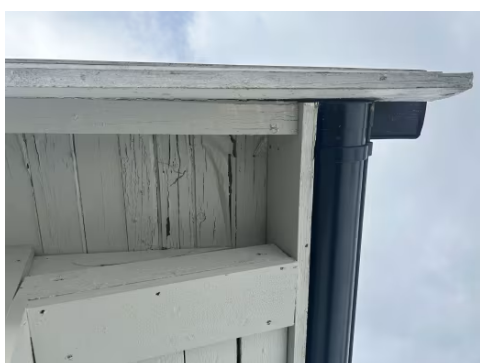
Lekkasje i tak.
