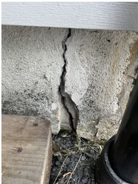
Sprekker i grunnmur.
