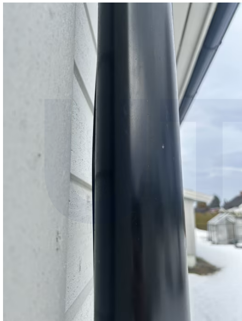
Frostspreng i nedløp.
