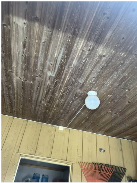
Sverte/muggsopp i taket.
