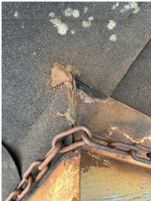
Skade på beslag og shingel rundt pipe.
