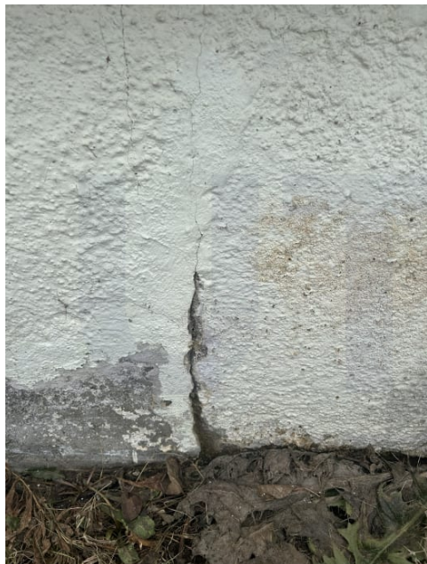
Sprekker i grunnmur.
