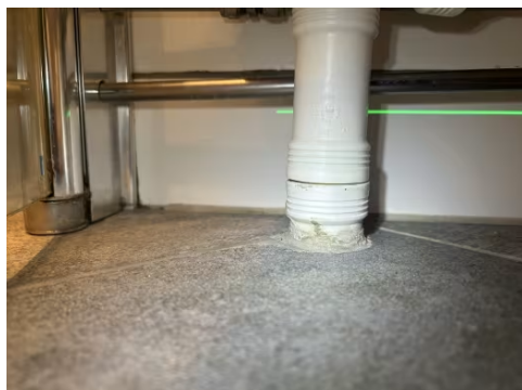
Manglende tettesjikt på rørgjennomføring.
