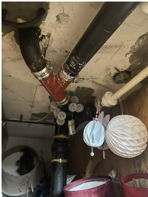
Avløp i kjeller.
