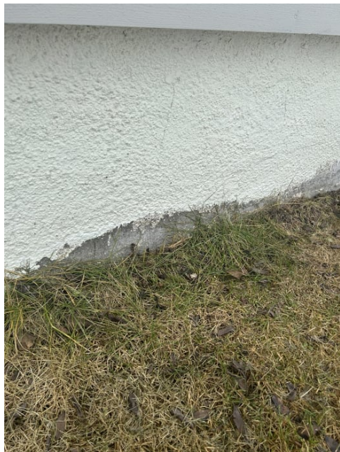
Sprekker i grunnmur.
