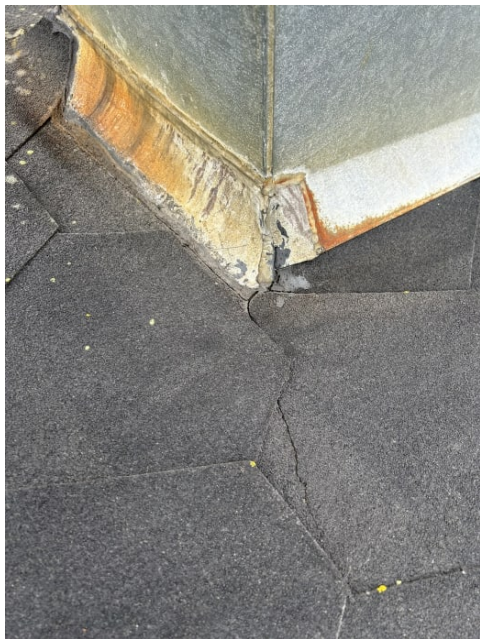
Skade på beslag og shingel rundt pipe.
