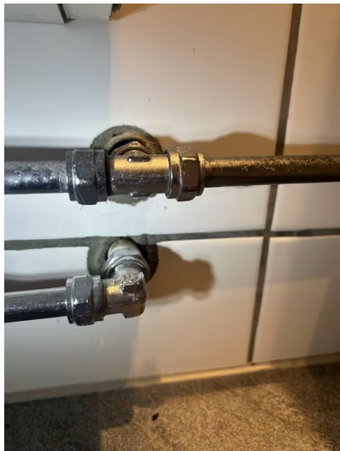
Manglende tettesjikt på rørgjennomføring.
