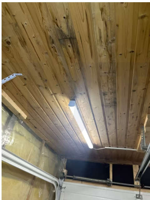
Sverte/muggsopp i taket.
