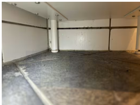
Manglende tettesjikt på rørgjennomføring.
