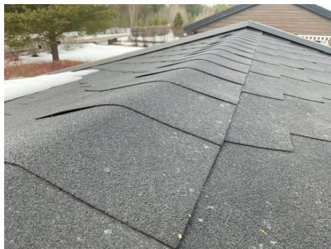
Svank i tak over garasjen.
