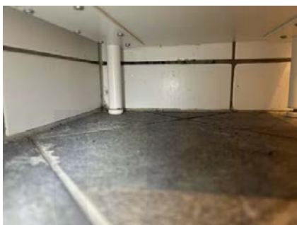
Manglende tettesjikt på rørgjennomføring.
