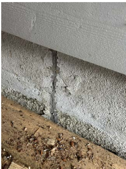
Sprekker i grunnmur på garasjen.
