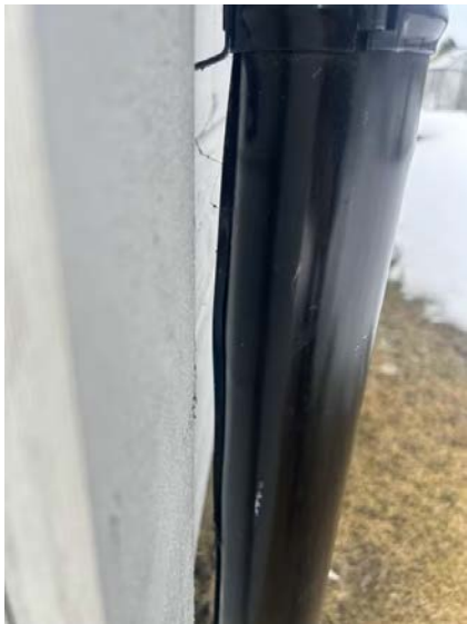
Frostspreg i nedløp.
