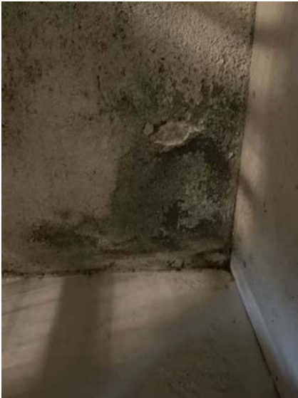
Salt/kalkutslag på pipe i kjeller.
