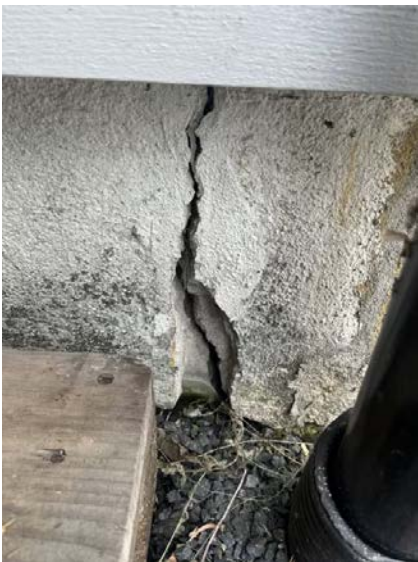
Sprekker i grunnmur.
