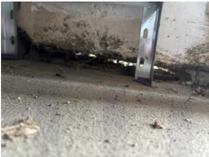
Manglende grunnmur på garasje.
