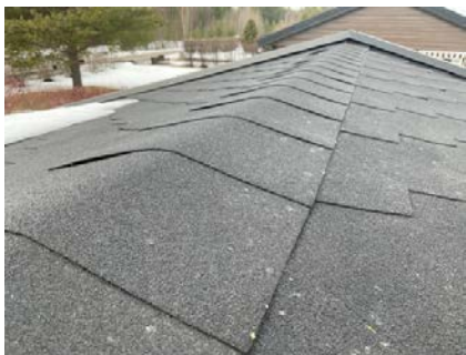
Svank i tak over garasjen.
