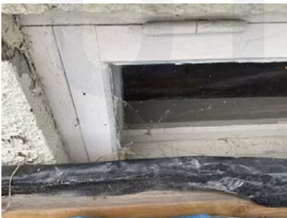
Sprekk i vindu.
