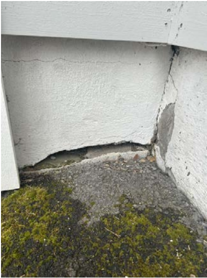
Manglende grunnmur på garasje.
