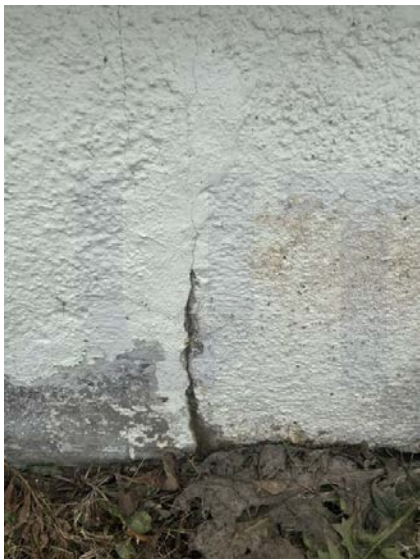
Sprekker i grunnmur.
