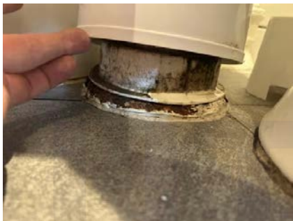
Manglende tettesjikt på rørgjennomføring.
