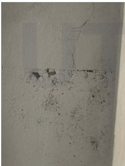
Salt/kalk utslag på grunnmur i kjeller.
