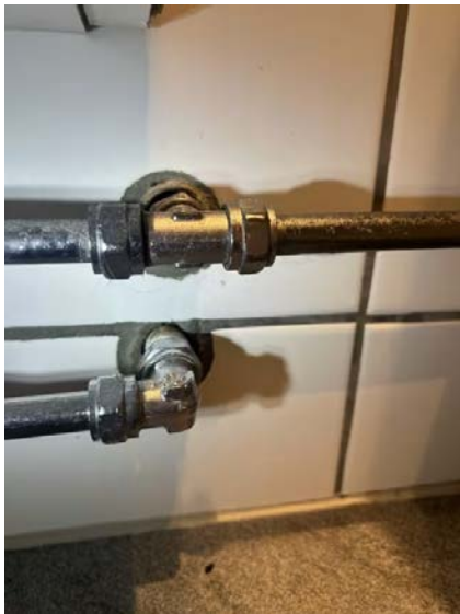
Manglende tettesjikt på rørgjennomføring.
