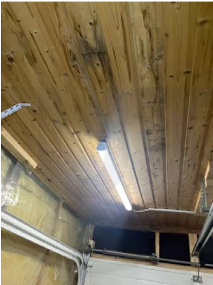
Sverte/muggsopp i taket.
