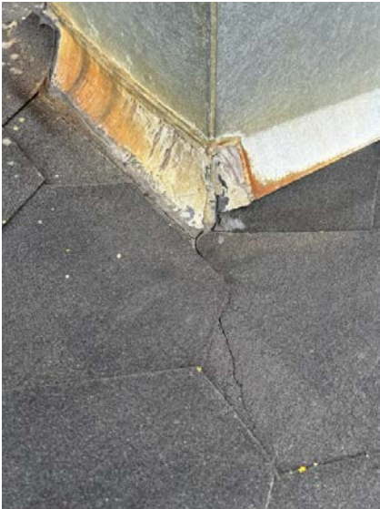
Skade på beslag og shingel rundt pipe.
