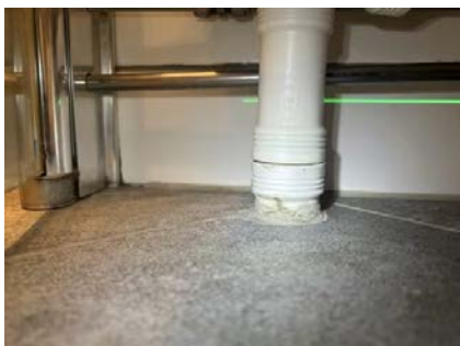
Manglende tettesjikt på rørgjennomføring.
