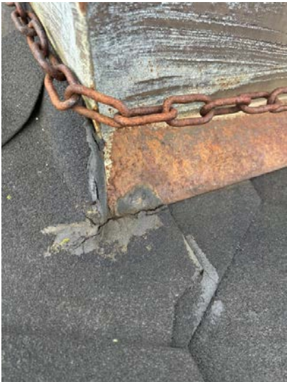
Skade på beslag og shingel rundt pipe.
