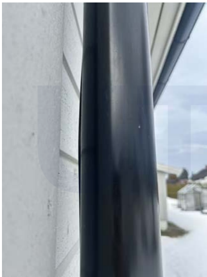
Frostspreg i nedløp.
