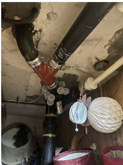
Avløp i kjeller.
