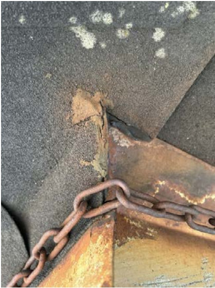
Skade på beslag og shingel rundt pipe.
