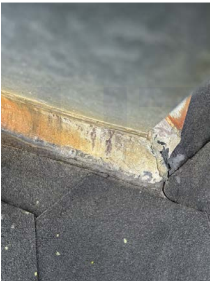
Skade på beslag og shingel rundt pipe.
