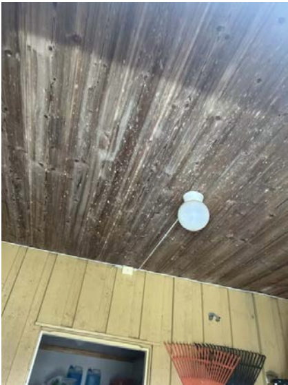
Sverte/muggsopp i taket.
