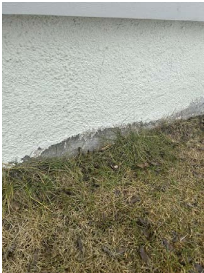
Sprekker i grunnmur.
