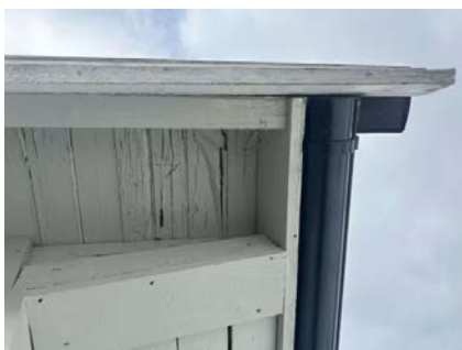
Lekkasje i tak.
