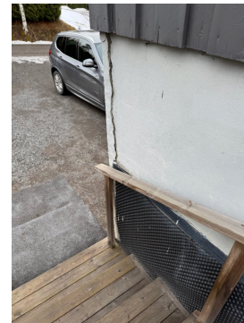
Sprekker i murverk og løsnet teglefasade
