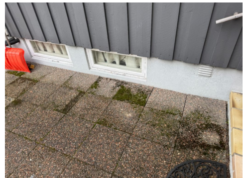
Ingen synlig tettesjikt
