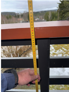
Stor åpninger og noe lavt rekkverk iht. dagens forskrifter
