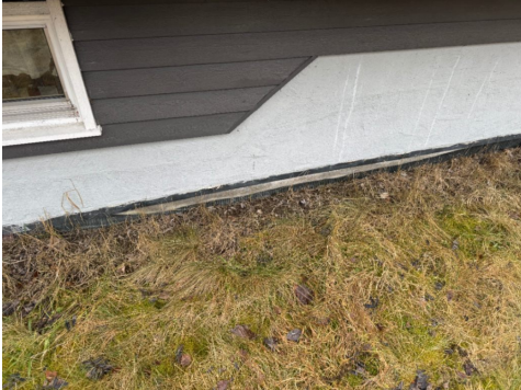
Dårlig og mangelfull klemlist
