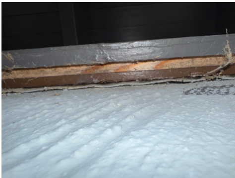
Dårlig/ingen luftespalte bak utvendig kledning
