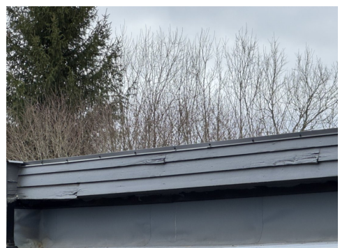
Råteskadet kledning/"vindskier" på tilbygget stuetak.
