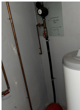
Nyere rørinnstikk m/vannmåler og stoppekran
