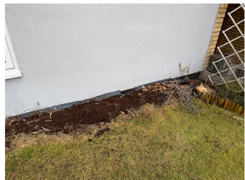
Dårlig og mangelfull klemlist
