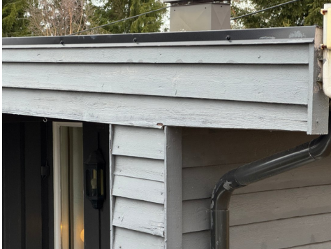
Råteskadet kledning vindskier og panel.
