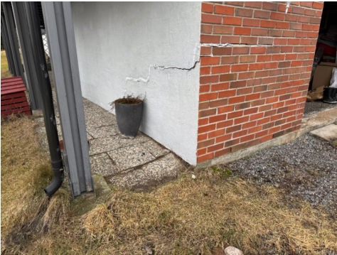
Løs teglsteinfasade og sprekker i murverk pga. setningskader.
