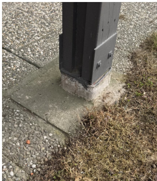
Fundamenter med antatt asbestholdige kanaler benyttet som forskaling.
