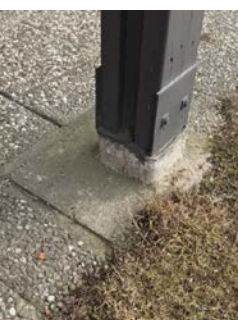
Fundamenter med antatt asbestholdige kanaler benyttet som forskaling.
