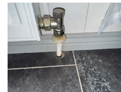
Tilførselrør i kobber m/plastkappe fra 1968 til radiatoranlegg
