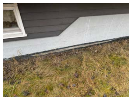
Dårlig og mangelfull klemlist
