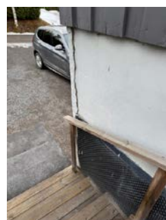
Sprekker i murverk og løstnet teglefasade
