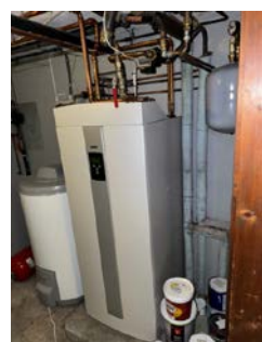
Gamle vannrør med ukjent type isolasjon (kan inneholde asbest).
