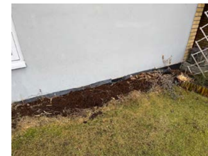
Dårlig og mangelfull klemlist
