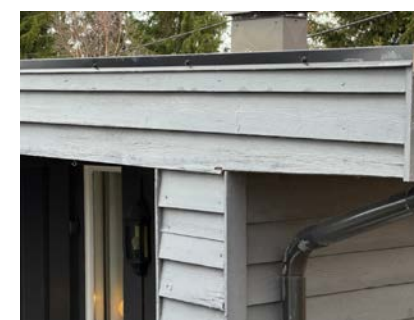
Råteskadet kledning vinds kier og panel.
