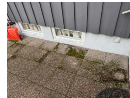
Ingen synlig tettesjikt
