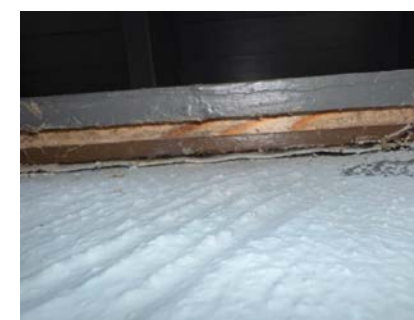
Dårlig/ingen luftespalte bak utvendig kledning
