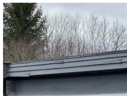
Råteskadet kledning/"vinds kier" på tilbygget stuetak.
