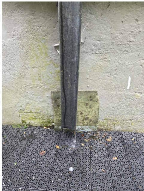
Nedløp avsluttet over bakken inntil bolig. Ikke grunnmursplast på mur.
