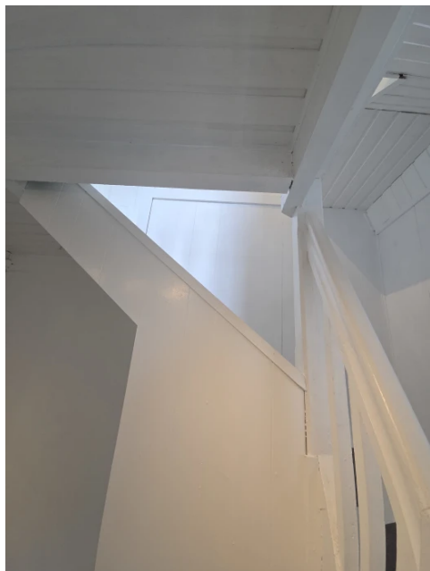
Rekkverk mangler i øvre del av trappa.
