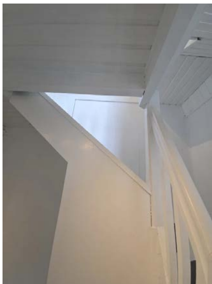
Rekkverk mangler i øvre del av trappa.
