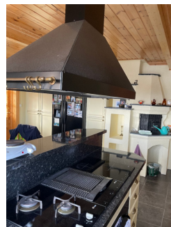
Vedfyrte grill på kjøkken. Komfyr med gass
