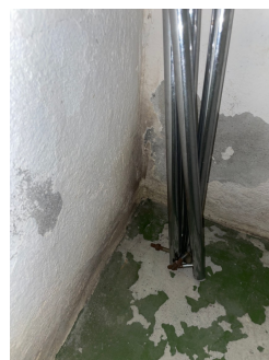
Fuktmerker på yttervegg ned mot gulv
