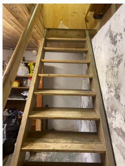
Trappen ned til kjeller har mangler som bør utbedres.
