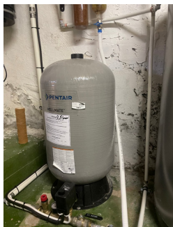
Trykktank i kjeller, installer ca. 2015
