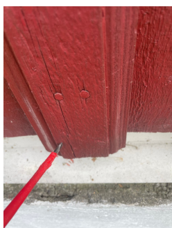
Noe sprekker og værslett kledning er helt normalt etter 33 år.
