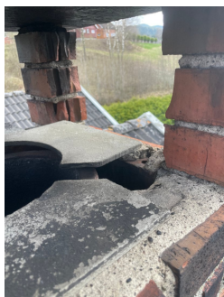
Dekkplate av skifer mellom røykrør og tegelsteinsforblending har sprekker og avskaling.
