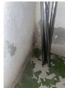
Fuktmerker på yttervegg ned mot gulv
