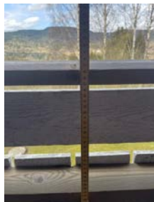
Rekkeverkshøyde på balkong 2. etg.
