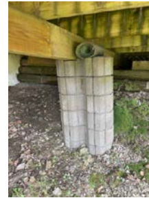
Noe skjevheter i søylepunkter ble registrert.
