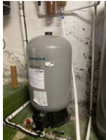
Trykktank i kjeller, installer ca. 2015
