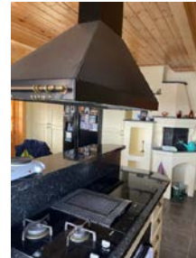
Vedfyrt grill på kjøkken. Komfyr med gass
