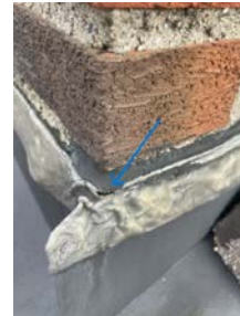
Sprekker i overgang bly og blikk bør tettes.
