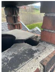
Dekkplate av skifer mellom røykrør og tegelsteinsforblending har sprekker og avskaling.
