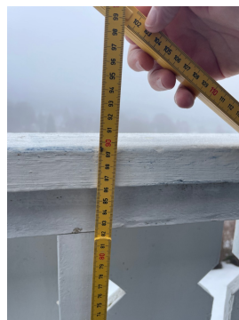
Høyde rekkverk veranda 90 cm (eldre krav)
