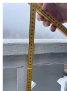
Høyde rekkverk veranda 90 cm (eldre krav)
