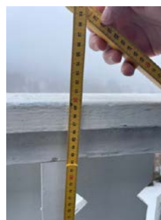
Høyde rekkverk veranda 90 cm (eldre krav)
