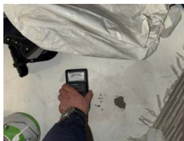
Forhøyede verdier ved fuktsøk på gulv i boden.
