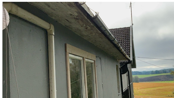
Råteskader og manglende lufting
