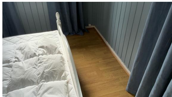
5 cm skjevheter i soverommet.
