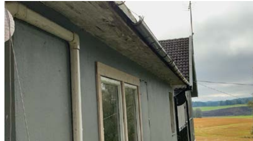
Råteskader og manglende lufting
