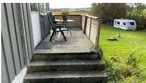
Rekkverk er skjevt og løst.
