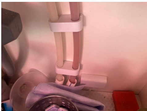
Varerør til vannrør mangler tetting i benkeskap på kjøkken.
