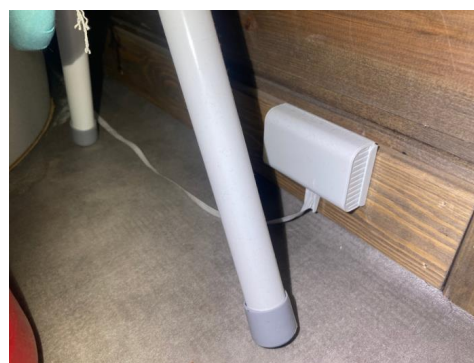
Sensor til lekkasjestopper på vaskerom.
