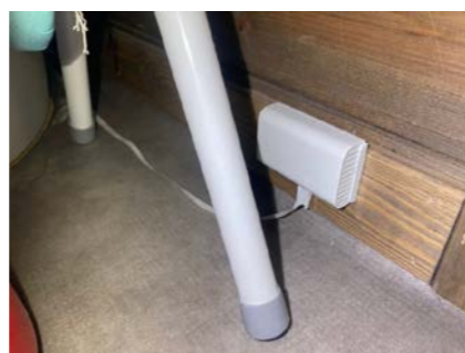
Sensor til lekkasjestopper på vaskerom.
