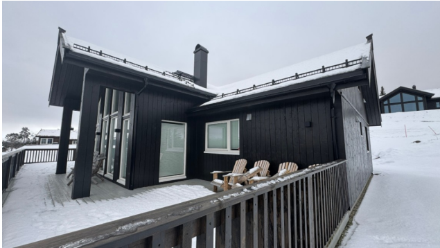
Bilde viser at terrassen var delvis dekket av snø på befaringdagen.
