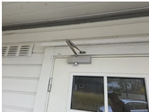
Mekanisme over ytterdør virker ikke, skal kunne låse døra i åpen posisjon.
