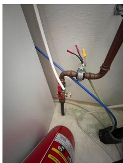
Utett rundt rør gjennomføring i gulvet
