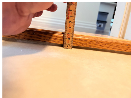
ca 8mm oppkant under dør til kjøkken.
