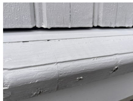
Enkelte kledningsbord med små sprekker.
