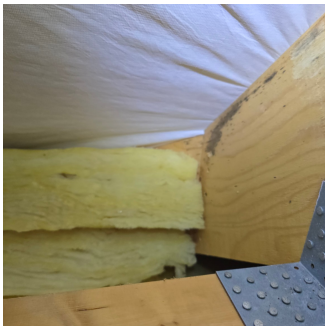
Etter utbedringen, fremdeles noe misfargede områder.
