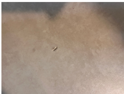
Skade på gulvbelegg.
