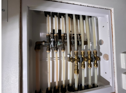
Rørkurser er ikke merket
