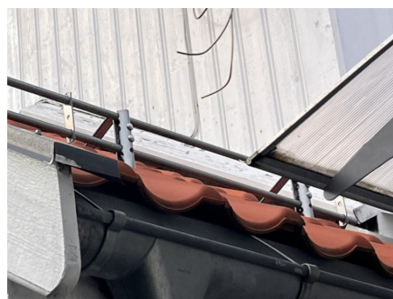
Noe rust på skruer/spiker på kledning.
