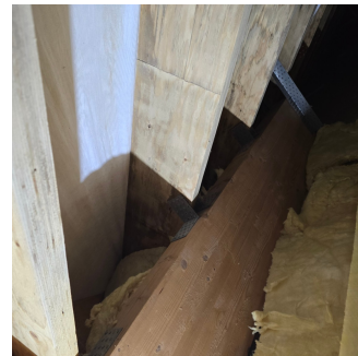
Sperrer er slipt og rengjort, fremdeles noe misfarging
