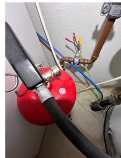
Utett rundt rør gjennomføring i gulvet
