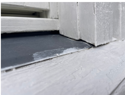
Lite åpning mellom omramming og vannbrett.
