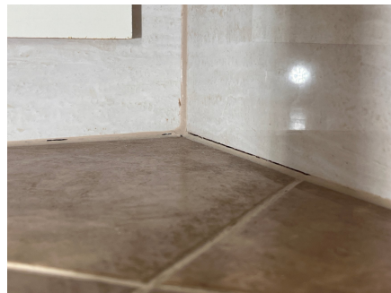
Sprekker i fuge mellom gulv og vegg under servantskap
