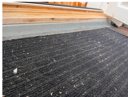
Vannbrett montert helt opp under terskel på hovedinngangsdør.
