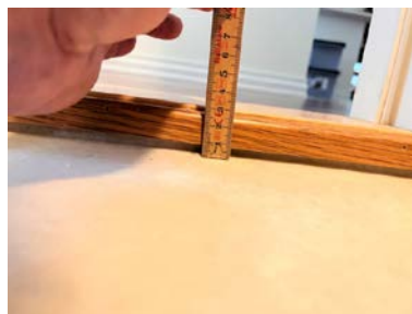
ca 8mm oppkant under dør til kjøkken.
