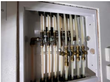
Rørkurser er ikke merket
