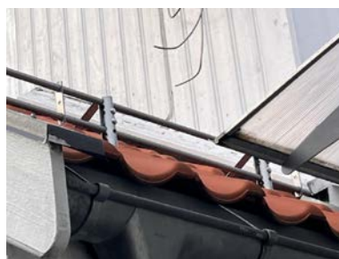
Noe rust på skruer/spiker på kledning.
