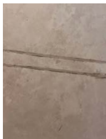
Små sprekker i sveis på gulvbelegget
