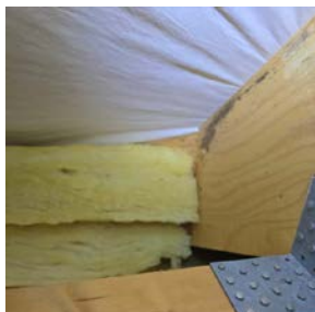
Etter utbedringen, fremdeles noe misfargede områder.
