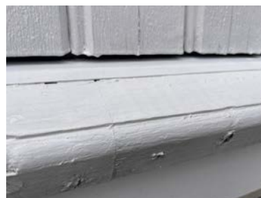
Enkelte kledningsbord med små sprekker.
