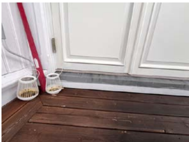
Balkongdør i kjøkken er noe påvirket av fukt Lite avstand mellom vannbrett og terskel.
