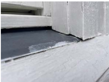
Lite åpning mellom omramming og vannbrett.
