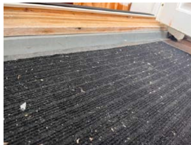
Vannbrett montert helt opp under terskel på hovedinngangsdør.
