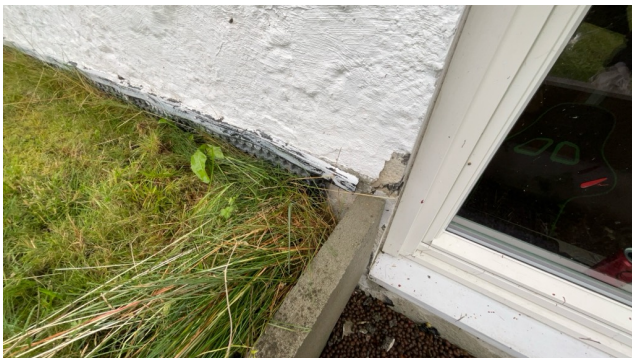
Stedvis behov for lokale utbedringer.
