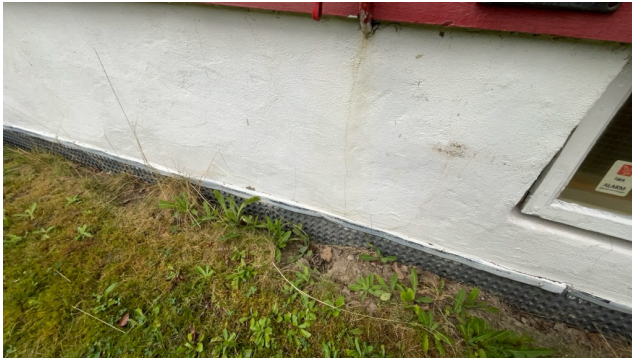
Stedvis behov for lokale utbedringer.
