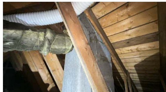
Synlig eternittkanal. Ved ønske og fjerning av kanal tilfaller dette ny eier.
