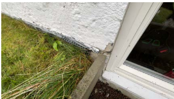
Stedvis behov for lokale utbedringer.
