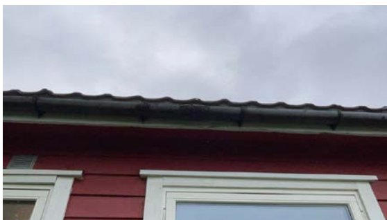
Overganger på renner bør utbedres. Renner bør skiftes på sikt.
