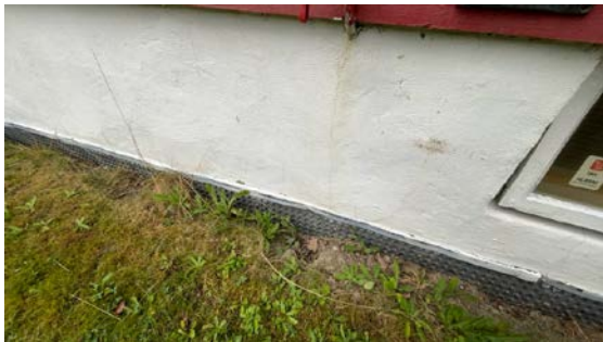
Stedvis behov for lokale utbedringer.
