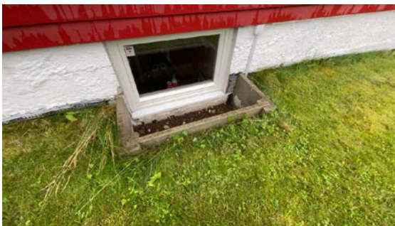
Vinduer ligger noe lavt ned mot terreng.
